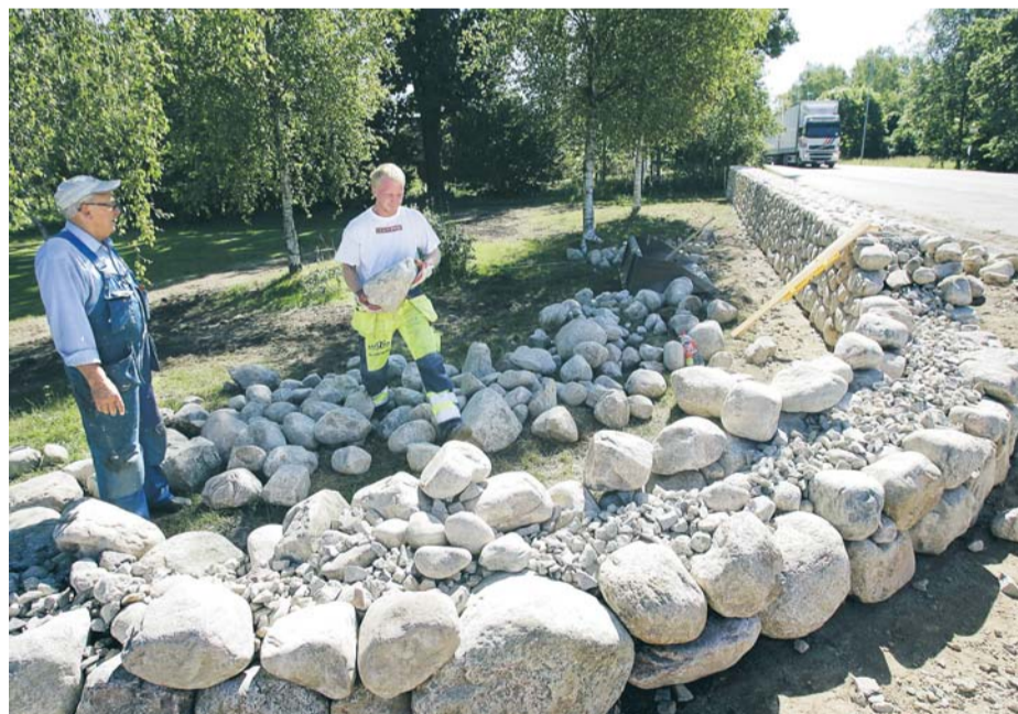
Bertil Nilsson bygger en fin stengårdsgård ut mot vägen med hjälp av Andreas Nilsson.
